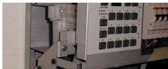
Vis de fixation de la section de contrôle 2ND par des disjoncteurs.
